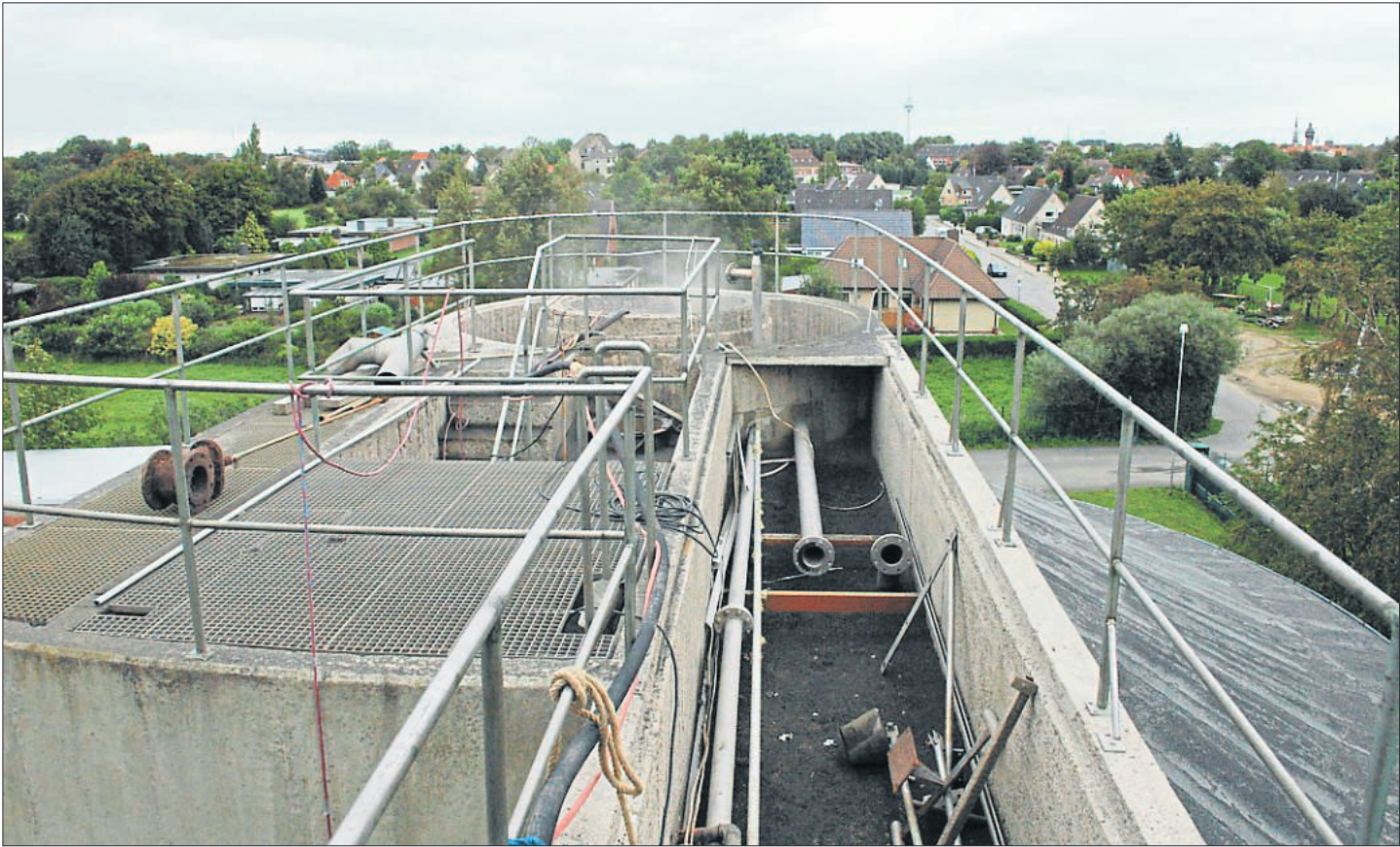
Blick über den Faulturm des Heider Klärwerks. Künftig wird die Gebühr für Schmutzwasser getrennt vom Regenwasser berechnet. Fotos: Lotze
