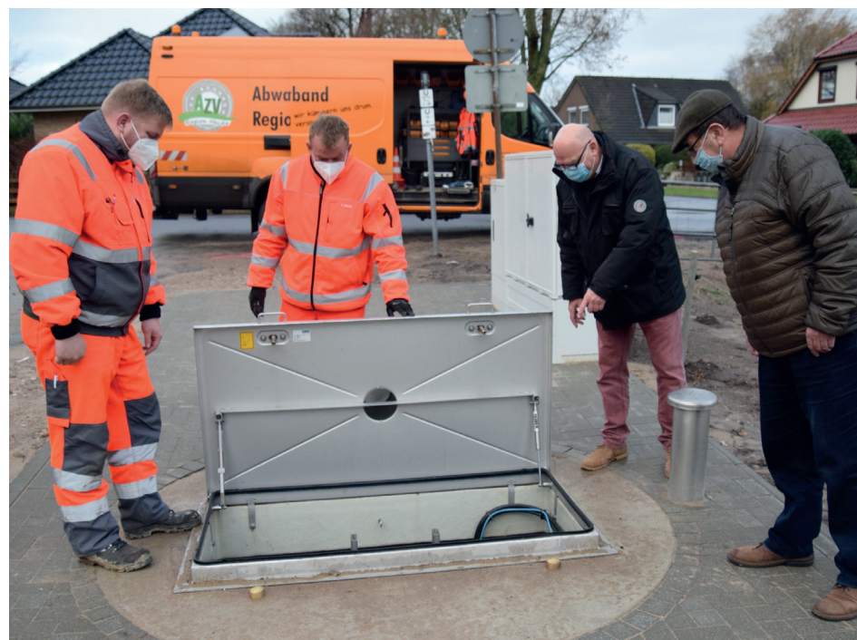
Die AZV-Mitarbeiter (v. li.) Torben Tetens und Thies Arndt, Verbandsvorsteher Uwe Krüger und Ostrohes Bürgermeister Harald Sierks werfen einen Blick in das Innere der neuen Druckrohrleitung. Foto: Seehausen
